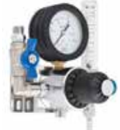
Puesto de trabajo con rotámetro
